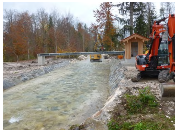
Abb. 4: Der neu errichtete Messsteg ist wichtiger Teil der Anlage. Von hier aus werden das ADCP-Messboot oder der Messflügel ins Wasser gelassen. Mit ihrer Hilfe wird die Abflussmenge der Bischofswiesener Ache gemessen. Foto: Wasserwirtschaftsamt Traunstein
